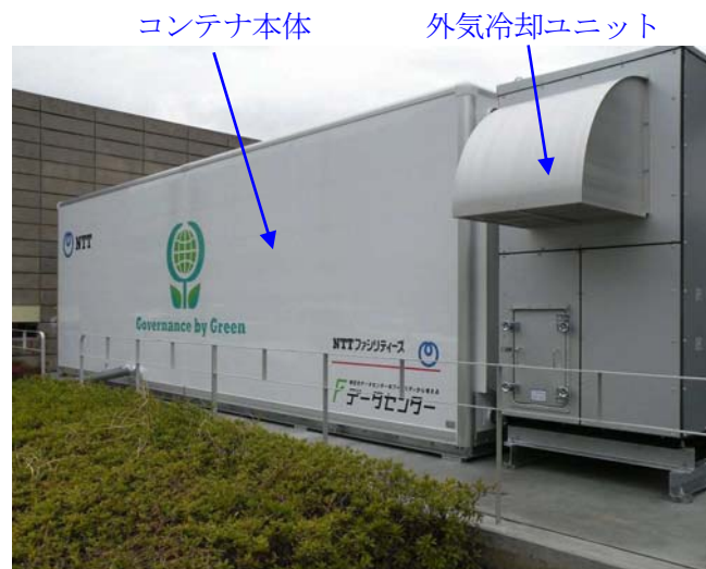
図1 NTT厚木研究開発センタに導入したコンテナ型データセンター
