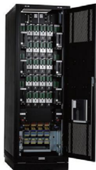
図4: HVDC分電盤(ヒューズタイプ)
